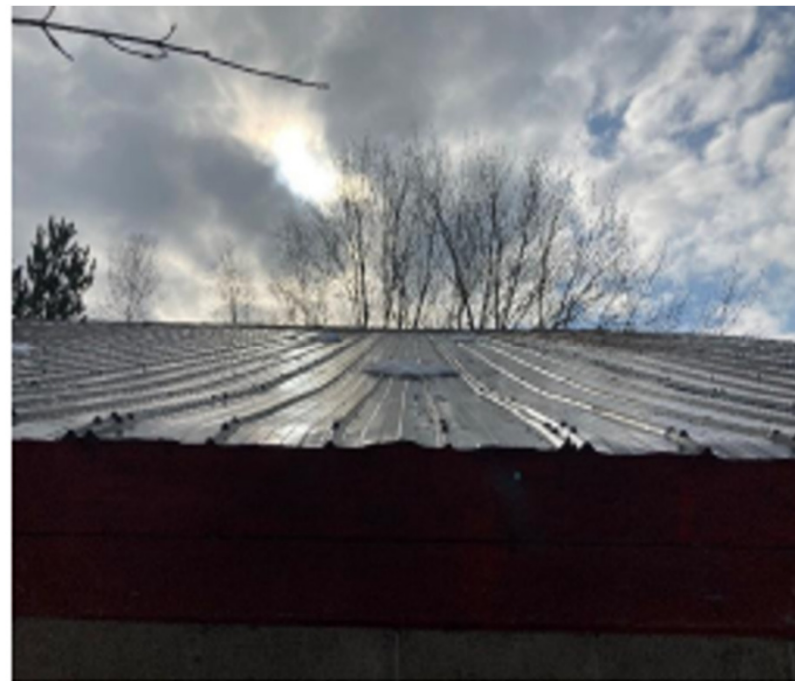
Couverture de tôle à refaire
