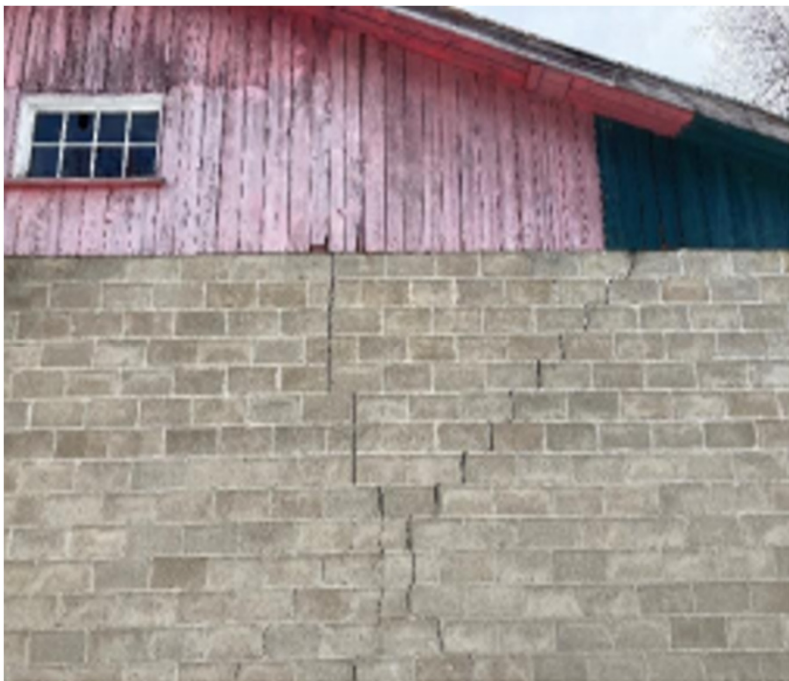
Fissures sur les murs de blocs extérieurs
